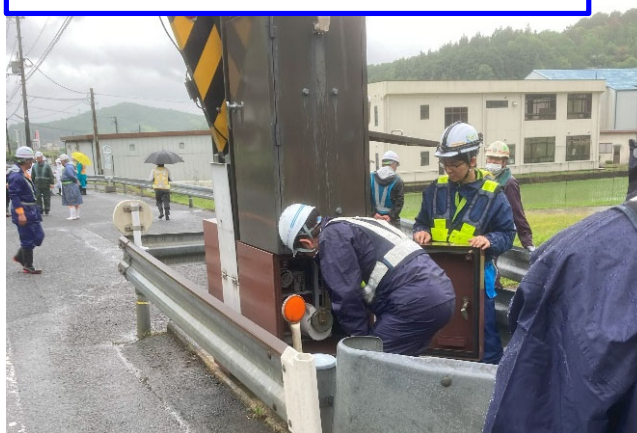
停電時を想定した遮断機手動操作訓練
