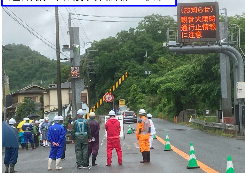
遮断機 自動操作訓練の状況
