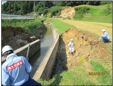
被災状況調査
