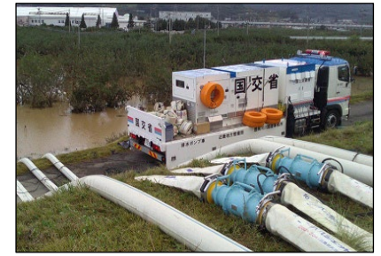
排水ポンプ車
