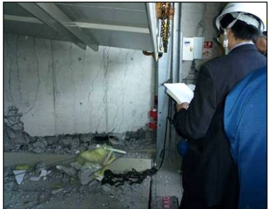
建物危険度判定
