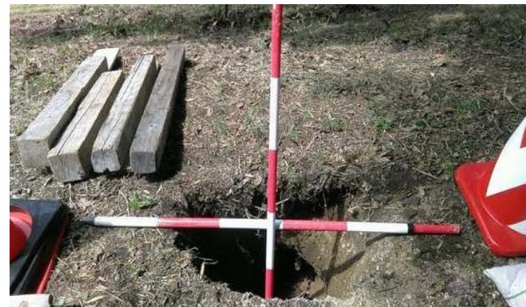
陥没発生状況（深さ1.5m）
