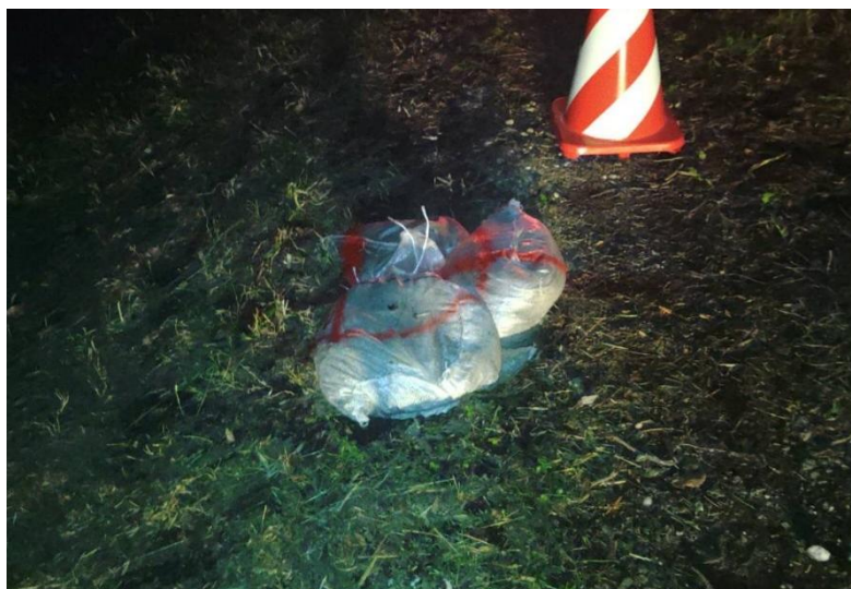
陥没による空洞部を土嚢により閉塞
