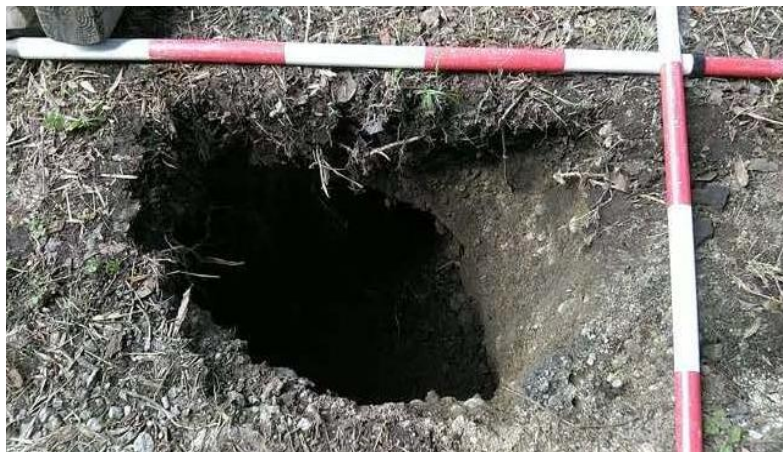
陥没発生状況（幅80cm×40cm）
