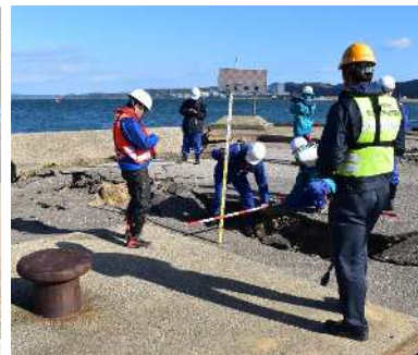
港湾被害状況の調査
