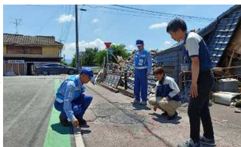
道路の被災状況調査(八代市)
