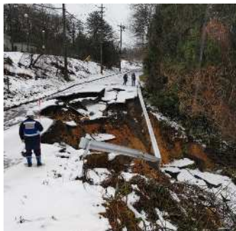
道路被害状況の調査
