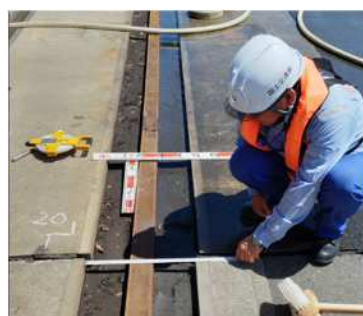
ガントリークレーン基礎の 被災状況調査(八代港外港地区)
