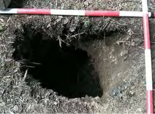
陥没発生状況（幅80cm×40cm）
