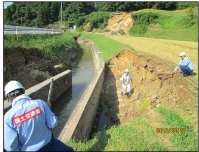
被災状況調査
