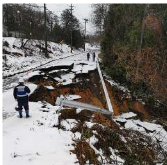
道路被害状況の調査
