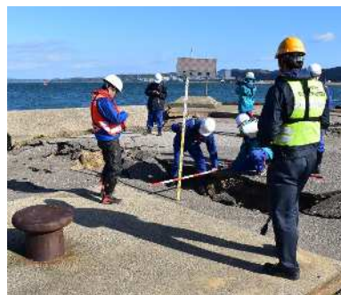
港湾被害状況の調査
