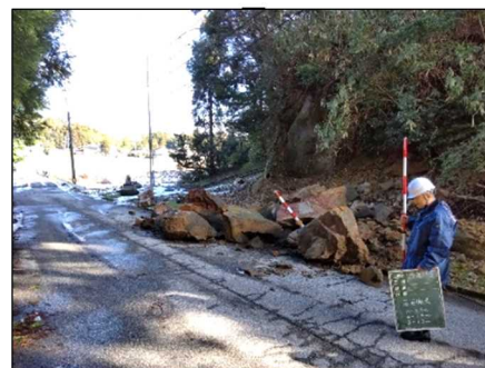
—被災状況（落石）—
