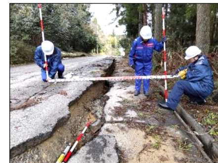
—被災状況（亀裂）—
