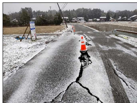
—被災状況（亀裂）—
