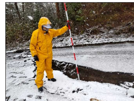
—被災状況（路面段差）—
