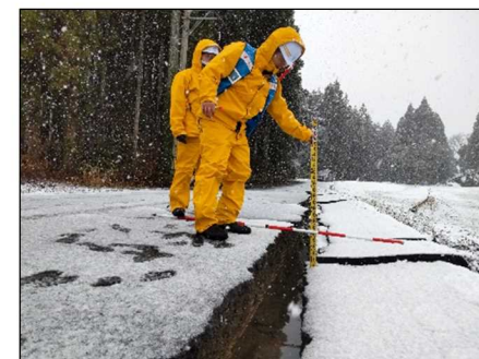
—被災状況（亀裂）—
