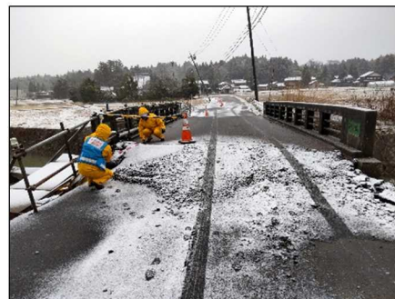
—被災状況（橋梁部の段差）—
