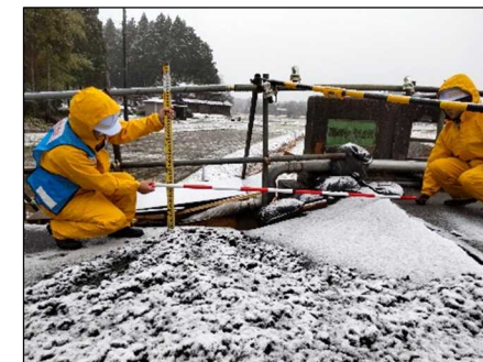
—被災状況（橋梁部の段差）—
