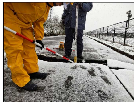
—被災状況（路面段差）—
