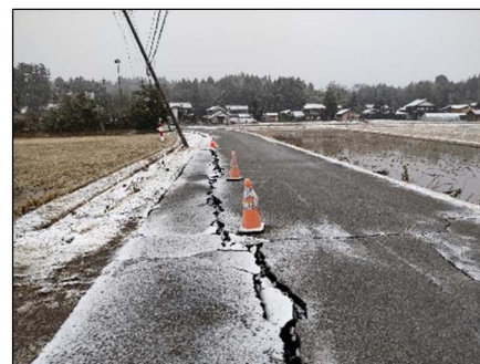
—被災状況（亀裂）—
