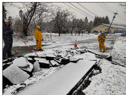
—被災状況（亀裂）—
