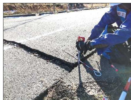
—被災状況（路面段差）—
