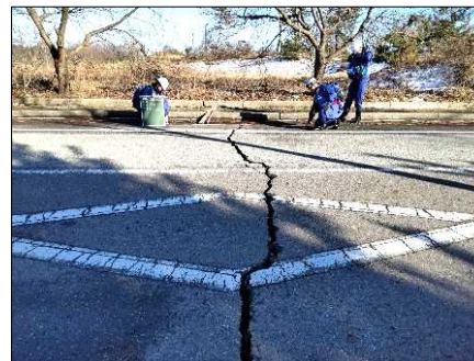
—被災状況（亀裂）—
