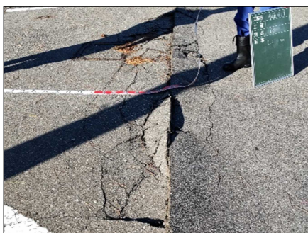
—被災状況（路面段差）—
