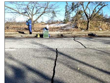
—被災状況（亀裂）—
