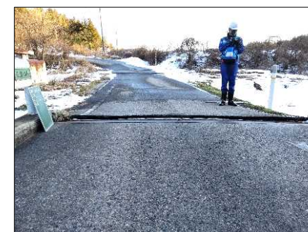
—被災状況（路面段差）—
