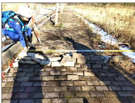
—被災状況（歩道ブロック損傷）—
