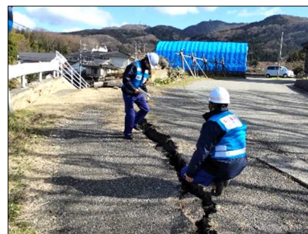
—被災状況（亀裂）—
