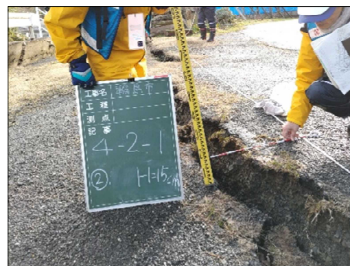
—被災状況（路面段差）—
