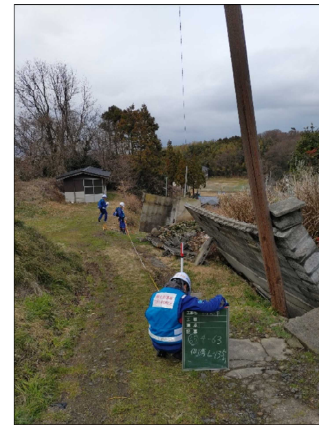
—被災状況（民家ブロックの倒壊）—
