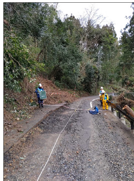
—被災状況（現状復旧と土砂崩落）—
