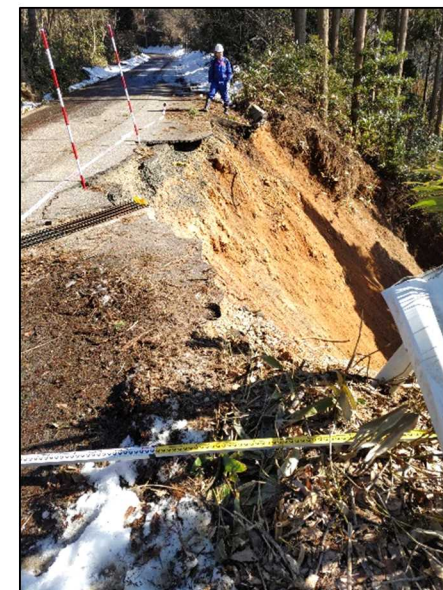
—被災状況（法面崩壊）—
