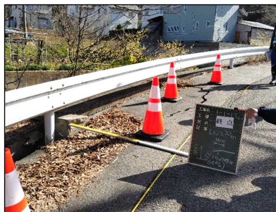
—被災状況（亀裂）—
