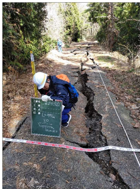
—被災状況（亀裂）—
