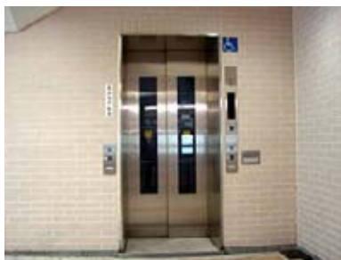
エレベーター(3号、4号出口側)
