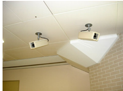
カメラ(地下広場)
