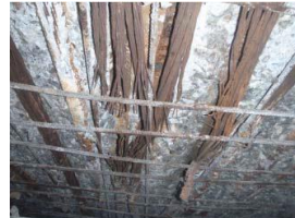
PC鋼材の腐食例
