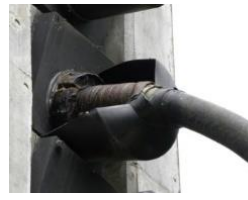
ケーブル損傷例
