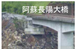
阿蘇長陽大橋 斜面変状による橋台の沈下
