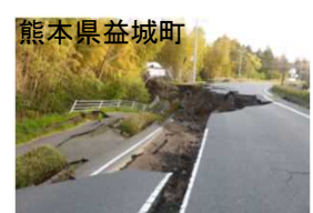
熊本県益城町 盛土の崩壊
