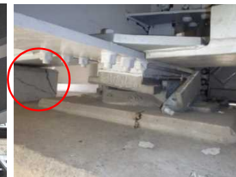
写真-6 支承の破損の状況
