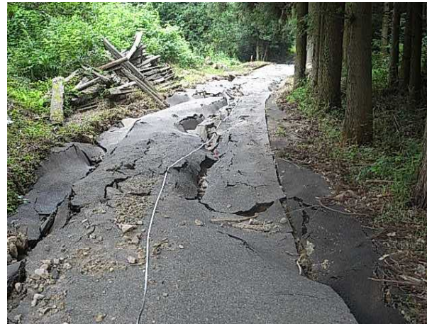
町道直地線の緊急調査(第1陣)
