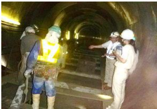
御堂筋共同溝インバート(底部)のコンクリート打設見学
