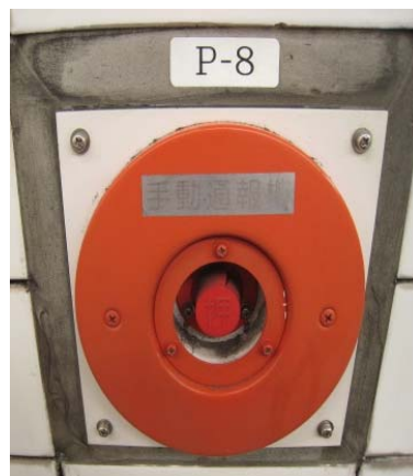
非常警報装置
