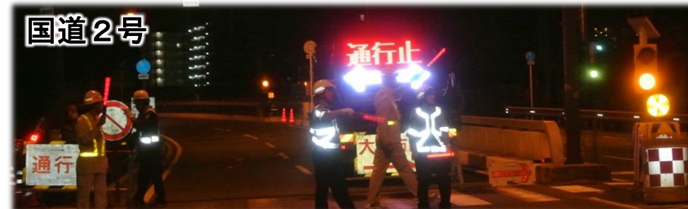
—国道の通行止め規制状況—
