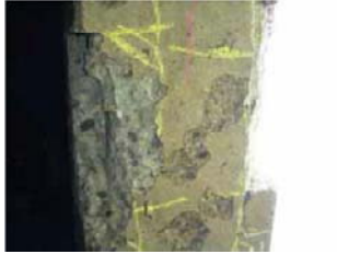
図-3 コンクリートの剥離
