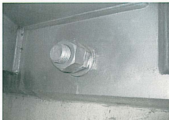
不用穴を隠しているとみられる状態
