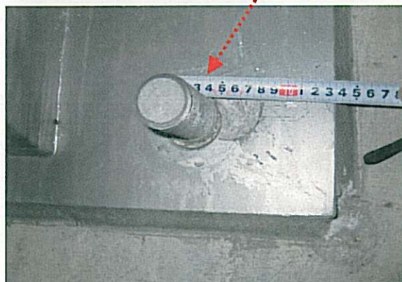
塗装を剥ぐと、アンカーボルトの 横に不用穴が確認できる
