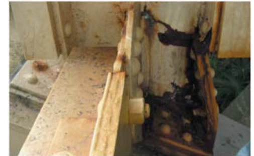
支柱の座屈(国道1号白川橋)
