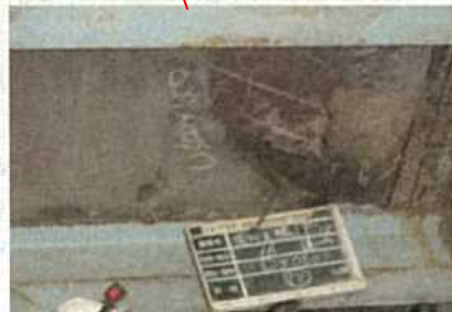
漏水・遊離石灰
