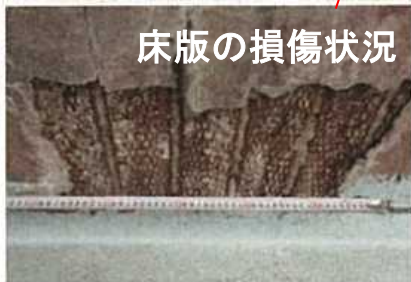
剥離・鉄筋露出
