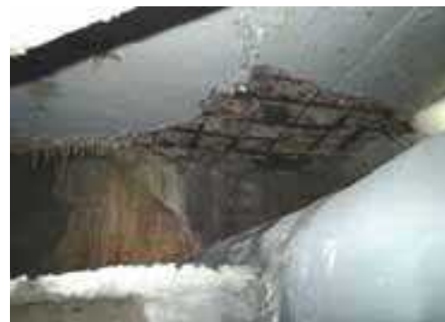
コンクリートの劣化
