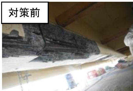
主桁鉄筋の腐食
