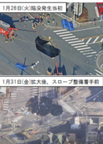
埼玉県八潮市における下水道管の破損に起因すると考えられる道路陥没 (写真出展) ANN NEWS
