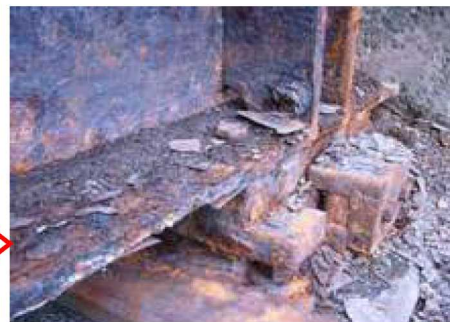
死角となっている箇所では損傷発見
