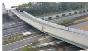
九州自動車道をまたぐ跨道橋の落橋 （県道小川嘉島線・府領第一橋）
