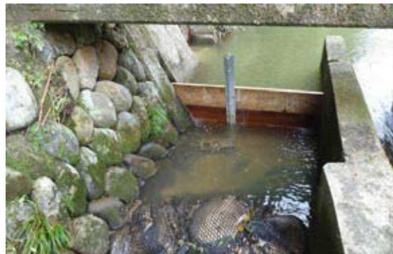
隔壁(流失なし)
