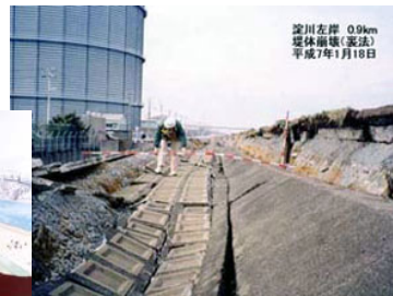
写真2-2-3 地震による護岸の倒壊
