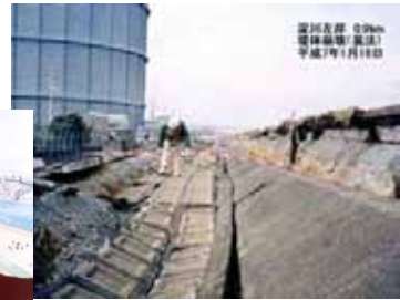
写真2-2-3 地震による護岸の倒壊
