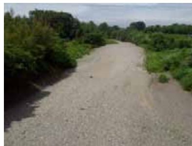
瀬切れした状態
