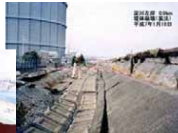
写真2-2-3 地震による護岸の倒壊
