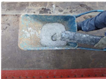
コンクリート打設時に使用する先行材を変更することで残コン削減
