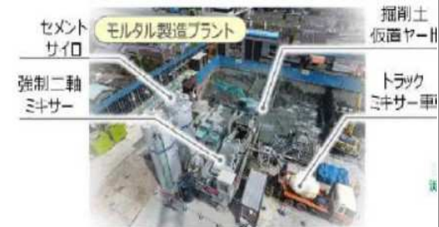
モルタル製造プラント
