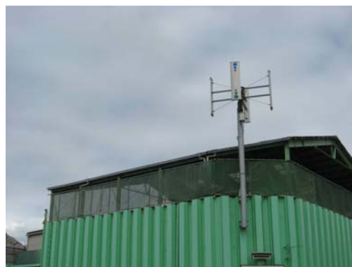
小型風力発電装置
