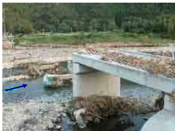
写真 - 6 被災した（町）下山脇橋
