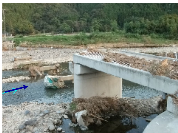
写真 - 6 被災した（町）下山脇橋
