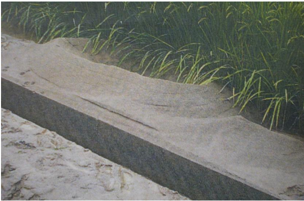
写真-2 噴砂状況 (貴志川左岸1.7k付近)
