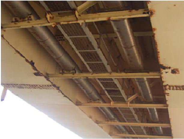
写真-3 ボルト, 雨かかりのない下フランジが錆びる (三国大橋)
