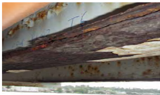
写真-1 河口部の橋桁の腐食
