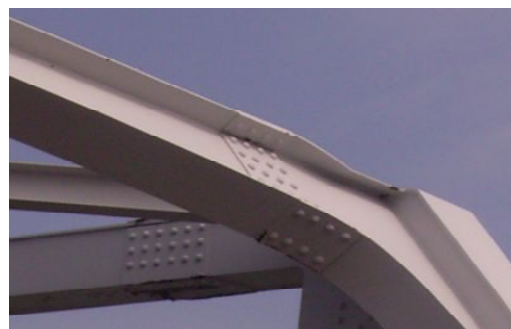
写真-2 写真-1と同じ橋の雨かかりの部分
