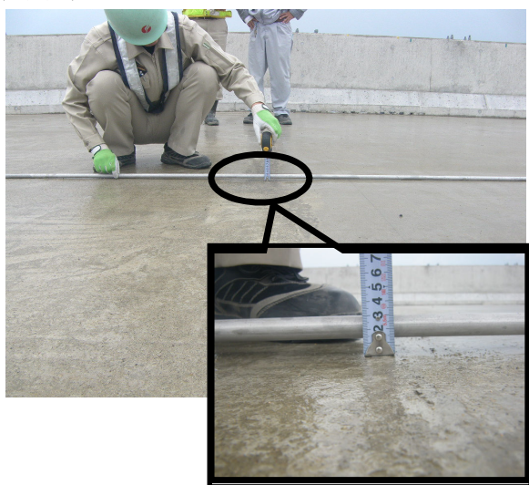
写真-1 放熱管と床版の不陸状況
