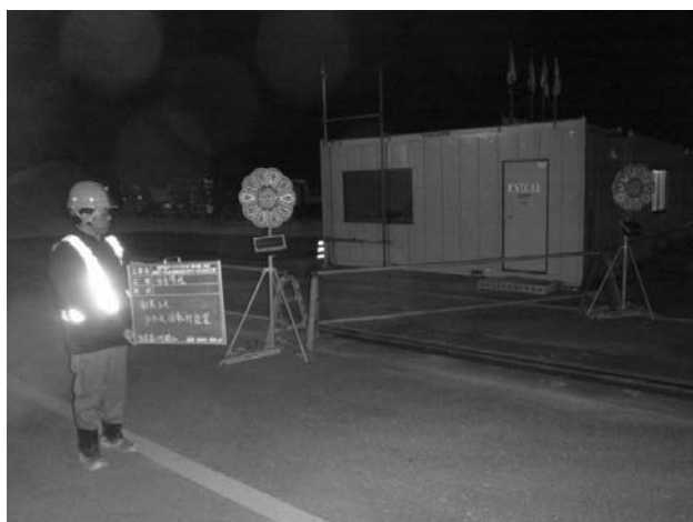
図-6 ガントリークレーン進入防止 対策用点滅灯設置状況
