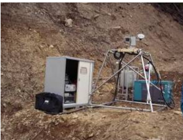
図-7 固定カメラ設置状況(長殿)
