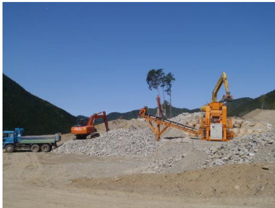
写真-4 ジョークラッシュャによる鋼製枠中詰材の製造状況
