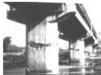
(a) 衝撃的な上下動によって生じた輪切り状のひび割れ破壊 1)
