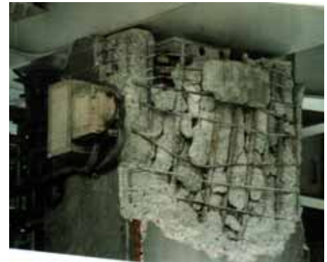
図-17 P463 山側柱の破壊(北面) 13)
