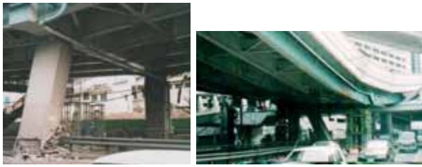
(a)P472 橋脚 15) (b)P477 橋脚(山側柱は南に傾斜) 15)
