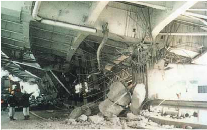
図-15 P458 橋脚(海側)柱の破壊状態(西より見る) 15) (奥に P457, P456 の海側柱が連続して壊滅的な破壊をしている)
