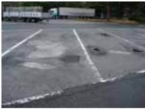
写真-1 路面損傷状況
