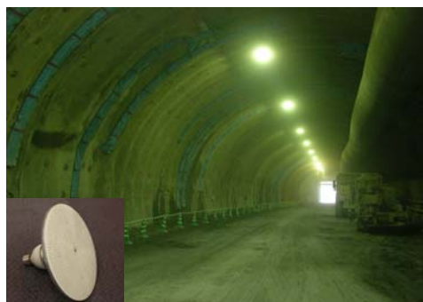
写真-3 坑内LED照明の使用状況
