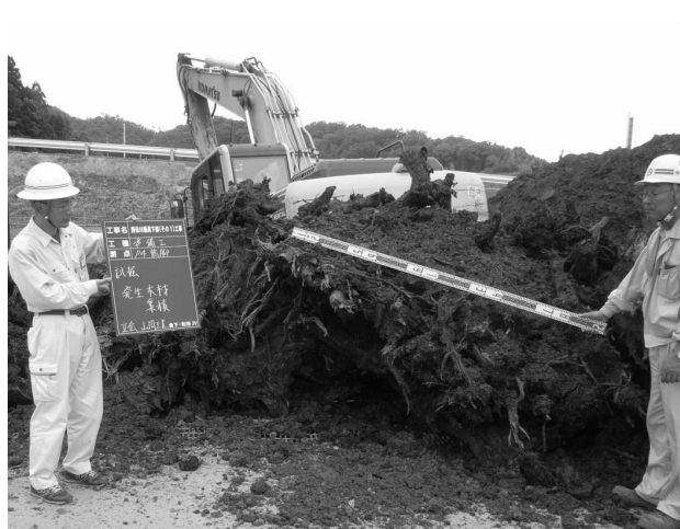
図-9 除去した木の根（約2m）
